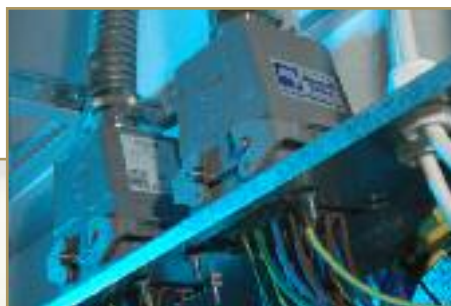
Внутренние кабельные сети MT32 связывают силовые и осветительные кабельные линии и главный распределительный щит.
