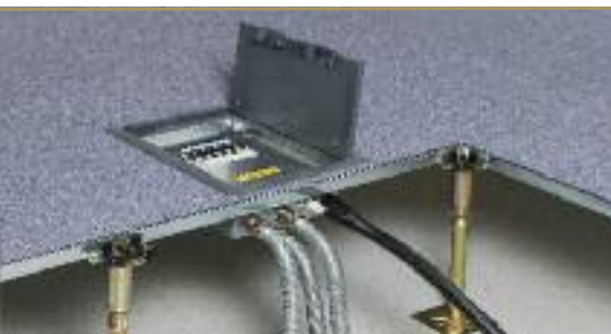
Распределительный блок с напольной электрораспределительной коробкой
